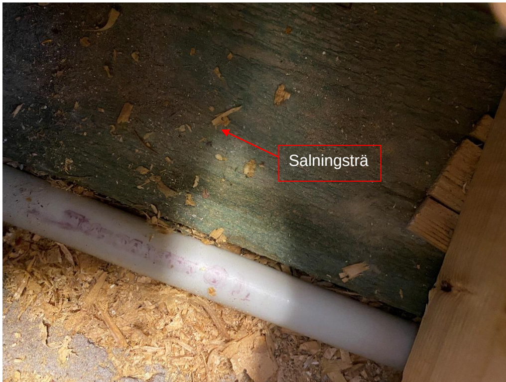
Foto 5, rikligt med byggskräp i konstruktion/provhål/ träskyddsbehandlat salningsvirke.
