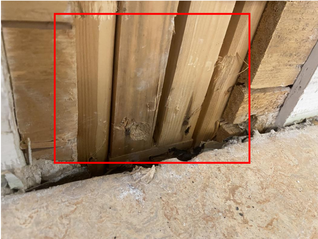
Foto 14, missfärgad ytterväggskonstruktion, PPG/V8.
