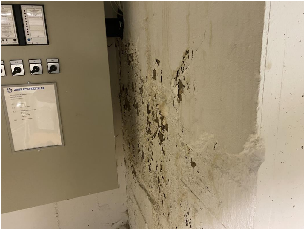
Foto 1, spår av äldre läckage från avloppsledning i källare under kök.
