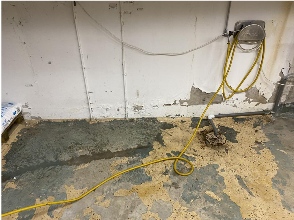
Foto 2, färgsläpp på källarvägg och källargolv i värmecentral.
