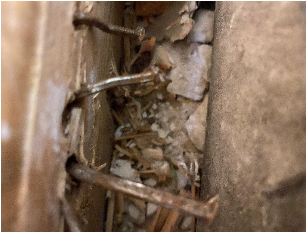
Foto 13, foto, motgjuten vägg PPG/V8, under golvnivå, rostiga spikar, mikrobiell lukt.
