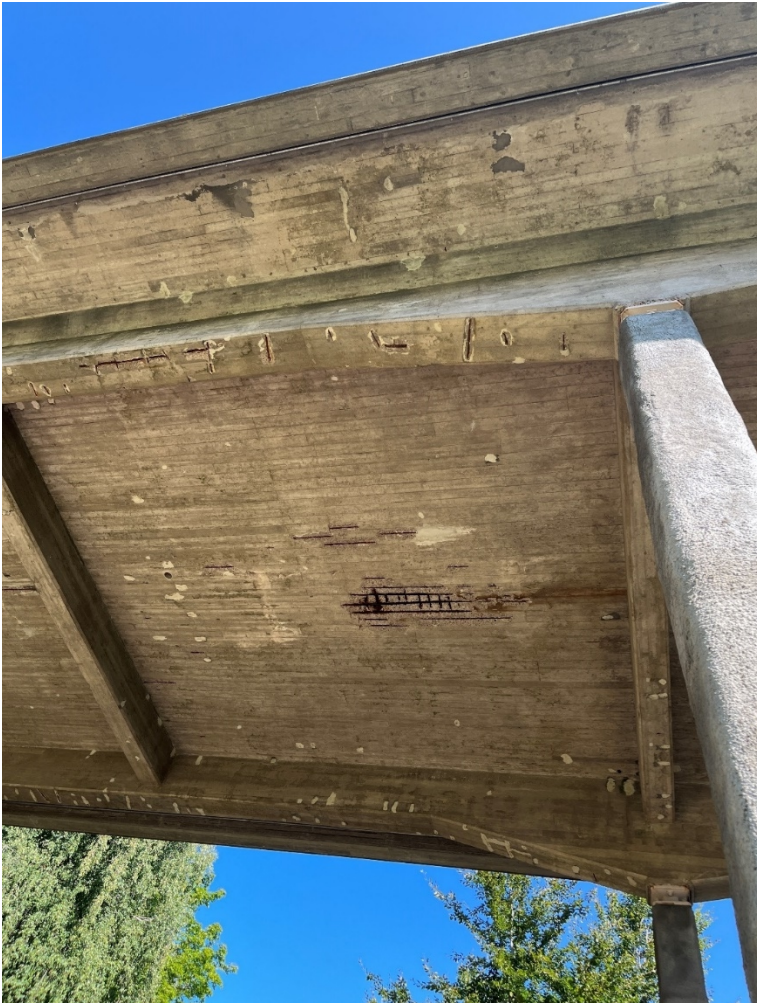
Figur 2 Utspjälkad betong längs undersidan. Bilden avser facket vid pelare N. Berört fack är även det som identifierats som kraftigt underdimensionerat.
