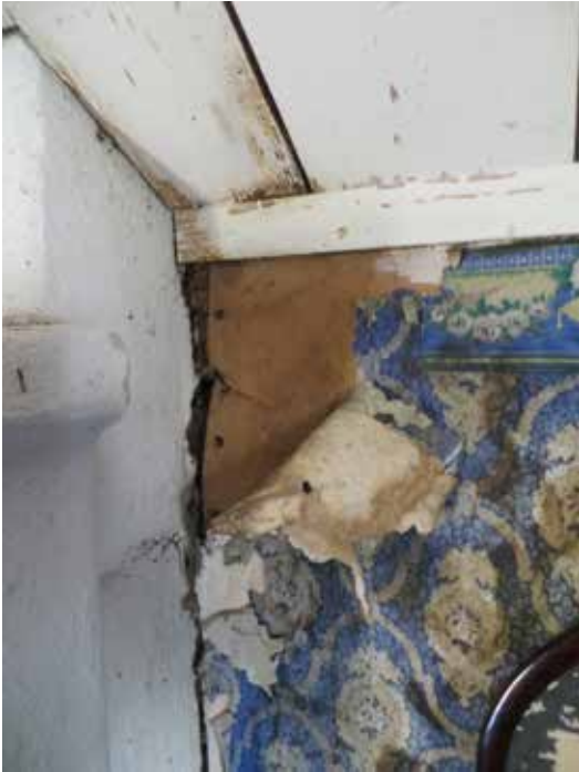
Boningsrummets tapeter har en del skador som bör lagas av en sakkunnig målare eller konservator.
