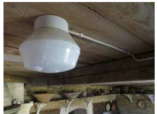
Installationen av belysning gör interiören mer tillgänglig, men skulle i flera fall kunna göras mindre iögonfallande med modern teknik.
